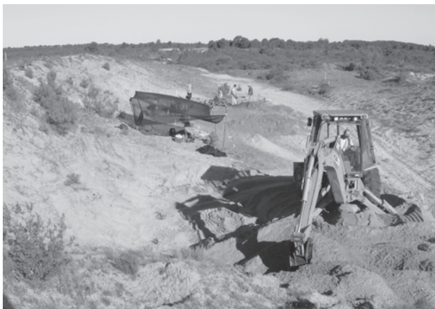
Figura 9. Trabajos de apertura de Pista 3 para Exc. VI y desarrollo de trabajos de excavación manual en Exc. V Ampliación
