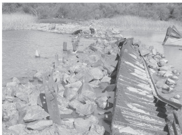
Figura 3. Detalle de restos de plataforma de metal sobre escollera.
